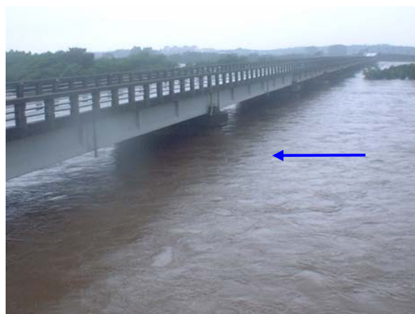
1.1km 旭橋上流左岸より旭橋を望む 河道断面不足
